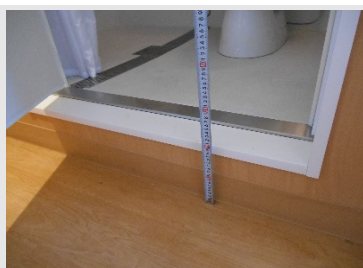
ユニットバスの入口にある段差
