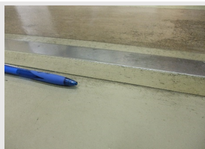
段差部分の写真
