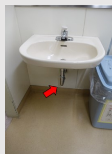
(右)汚物処理室内の洗面台下の配水管部分から水が漏れていた
