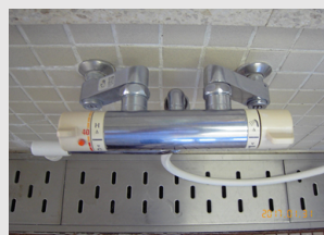
【事故直後の他の水栓部の調査時】
