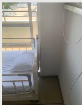
ベッドの壁の隙間
