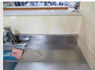
延長コードの設置個所。前面のステンレス台にポット2台が乗っていた
