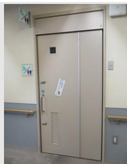
閉じ込めがあった中折れ戸
