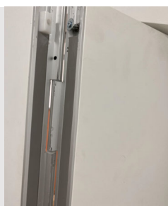
欠損している部品の部分（上部にある白いプラスチックが本来は対であるはずが入っていなかった）
