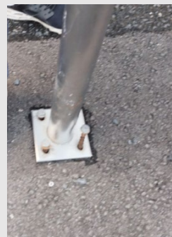
ボルトの固定部分の緩み写真
